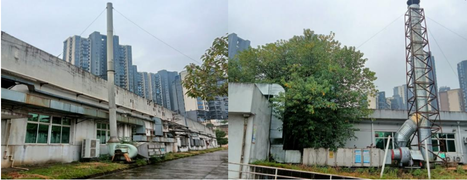
废气处理设施（部分）
